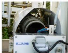
写真 3-14 第二洗浄装置
