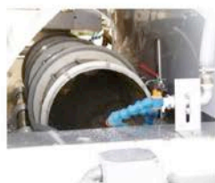
写真 3-12 第一洗浄装置
